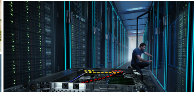
Skříň datového serveru přímo chlazená kapalinou
